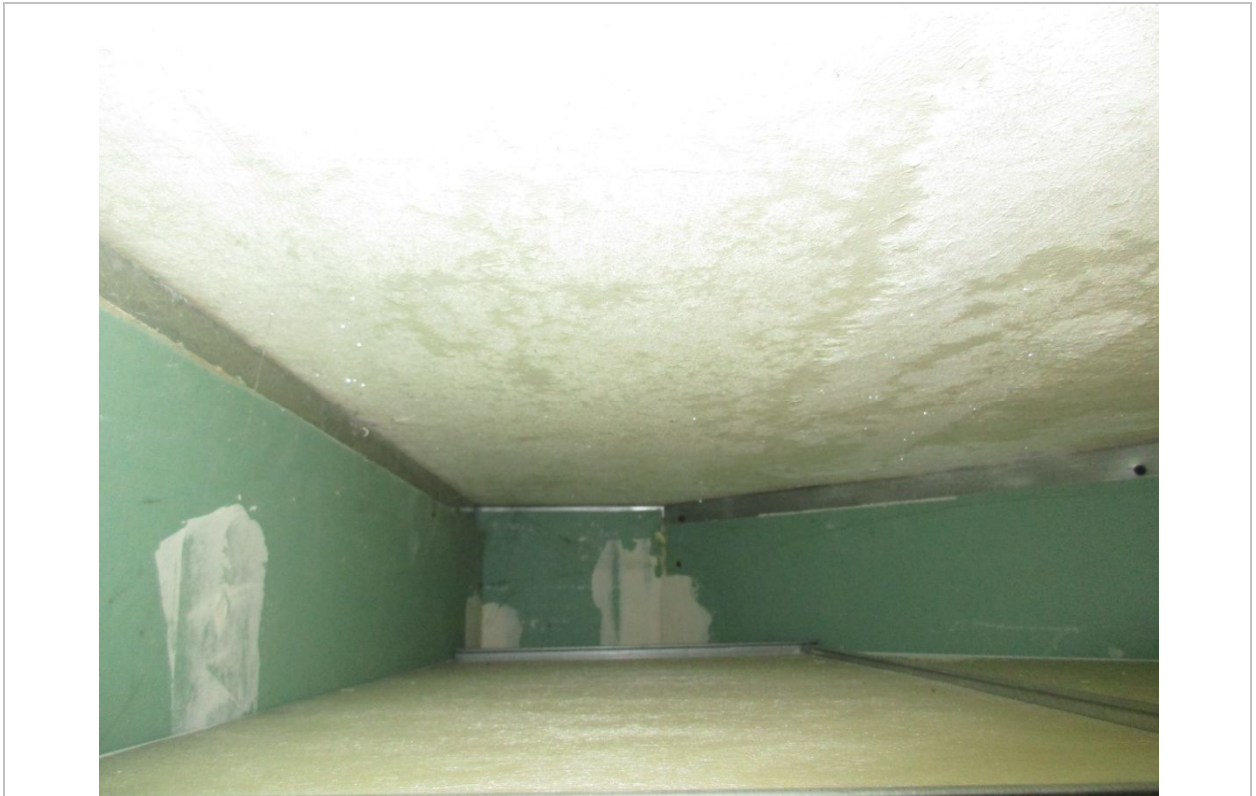
Mitruma kondensācijas pazīmes uz stāva pārseguma paneļiem ēkas daļā I
