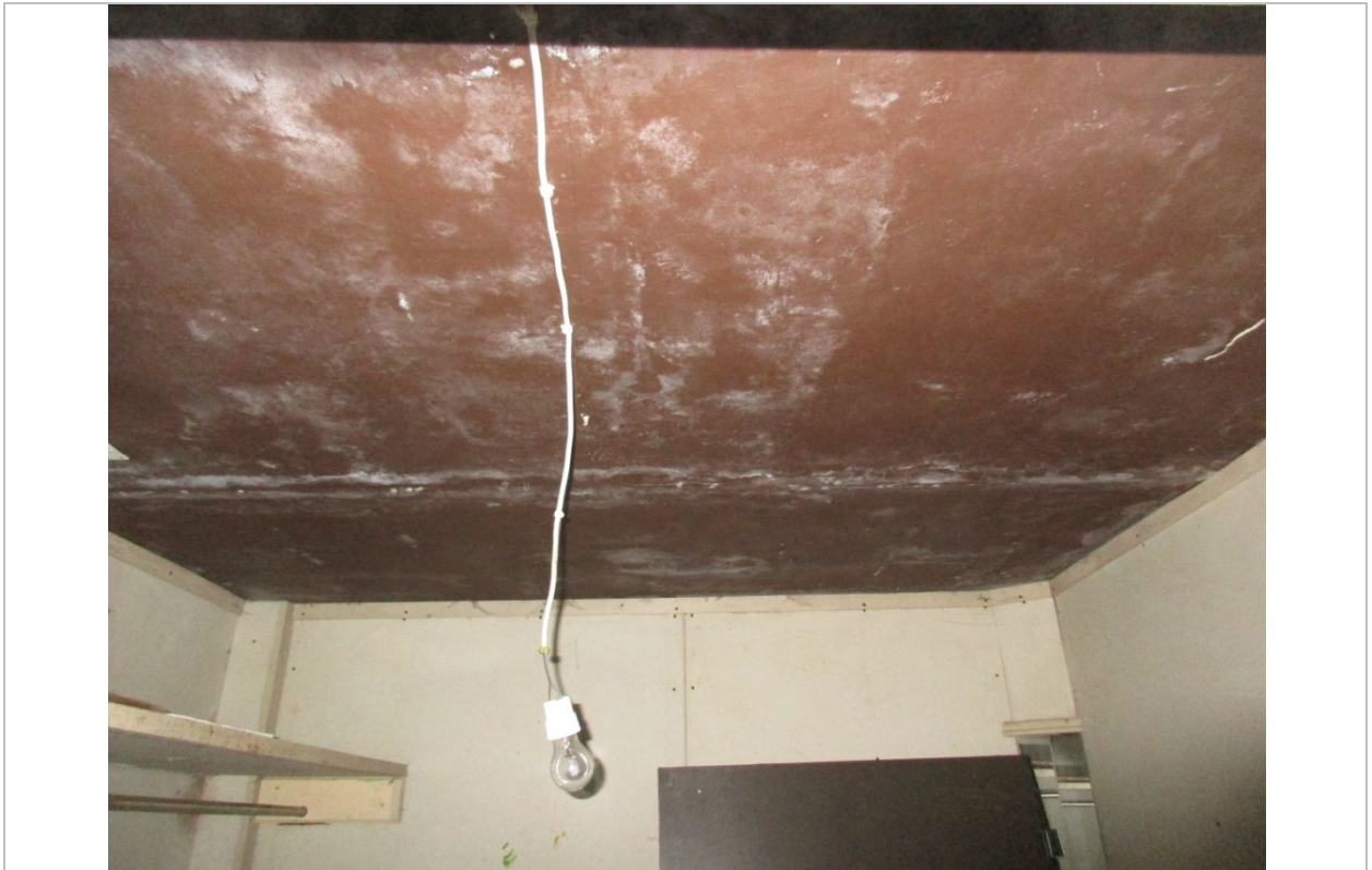
Elektroinstalācija ar pagaidu pieslēgumu, neatbilstošu (nedrošu) apgaismes ķermeni
