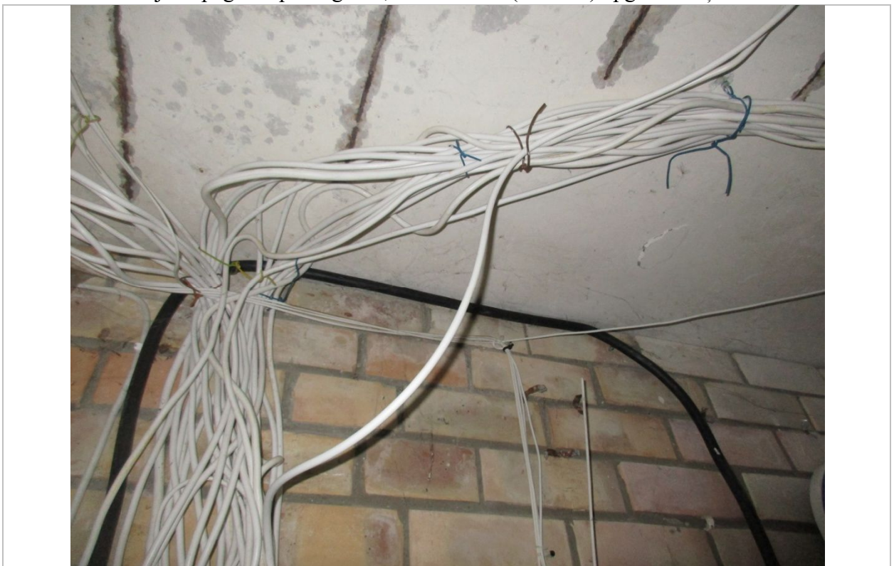
Telpu grupā II, III palīgtelpu pārsegumam stiebrojuma korozijas atslāņojumi. Elektroinstalācija nav izvietota uz kabeļu plauktiem, trepēm
