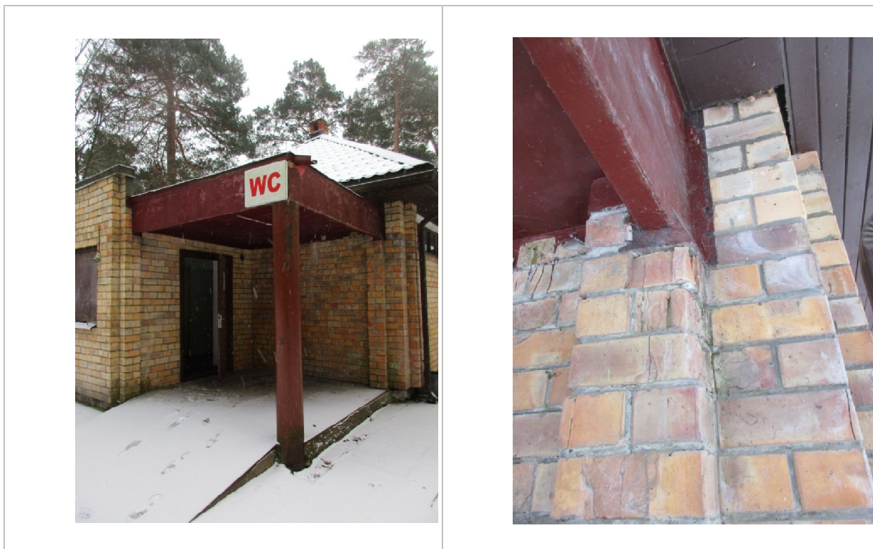
Ieejas mezglis ēkas daļā I un rīģeļa balstījums uz ķieģeļu stabiņa ar bojājumu pazīmēm (ķieģeļu plaisām)
