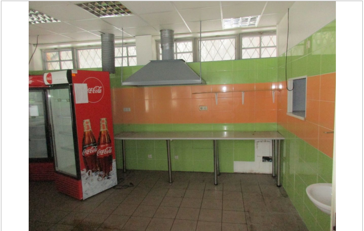
Telpu grupas III centrālās daļas cokola un stāva pārsegumi apmierinoši
