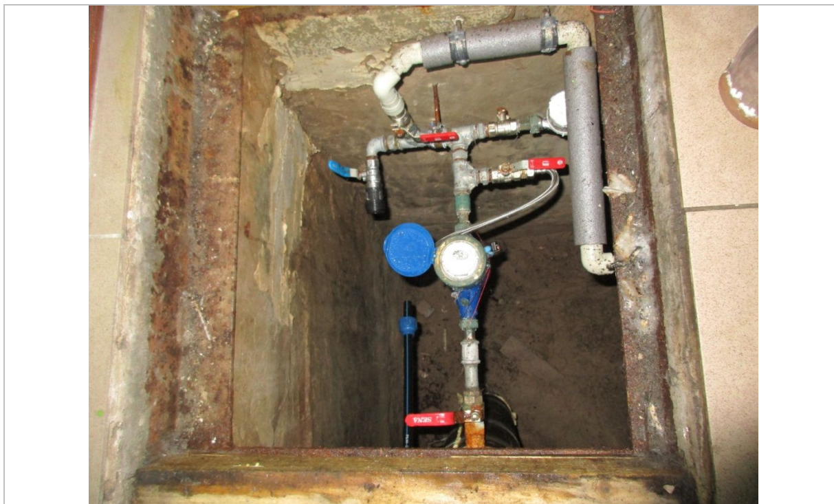
Ūdens vada ievads ar uzskaites mezglu. Viens no cauruļvadiem nav pievienots (atvienots)
